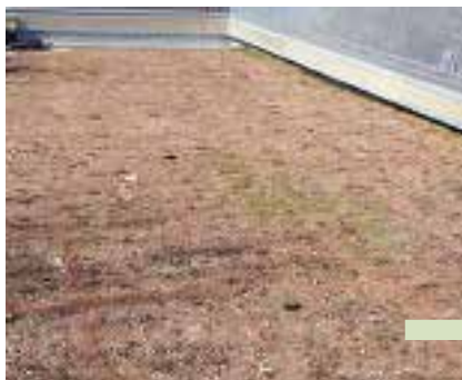
Takflate med manglende vedlikehold.
