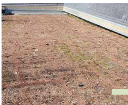
Takflate med manglende vedlikehold.
